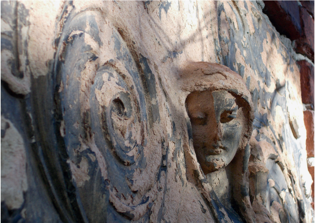
Abb. 7 Fortschreitende Zerstörung der Spolien an den Arkaden, 2014
